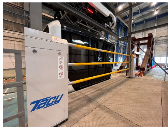
<プラットフォームに設置した昇降式ホーム柵>
