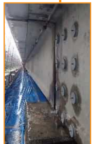
漏水箇所への適用例
