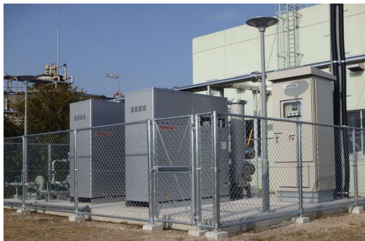
消化ガス発電設備
