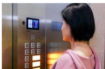
エレベーター制御システム
