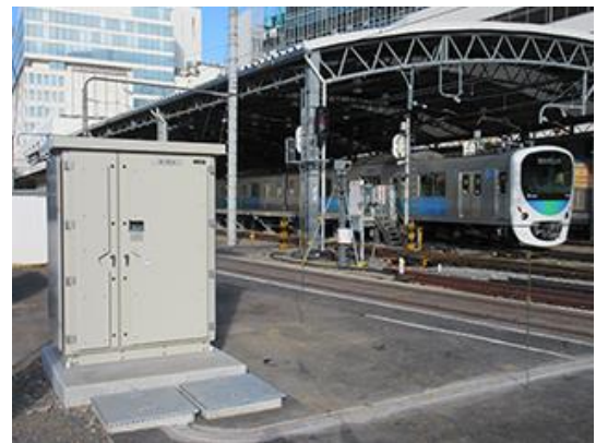
電車のブレーキ時に発生する回生電力を蓄電
