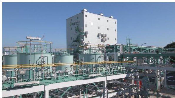
バイオジェット・ディーゼル燃料製造実証プラント
