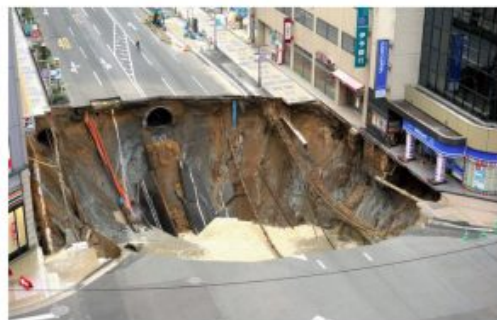
下水道管の崩壊によると思われる道路陥没事故
