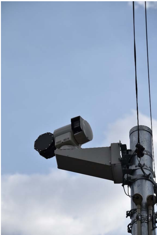
沼田川の舟木大橋付近に設置された河川監視カメラ
