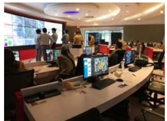
マカッサル市 スマートシティ・オペレーションセンター
