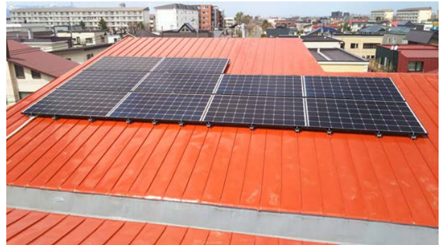
札幌みづほ幼稚園の園舎の屋根に設置されたそらべあ発電所
