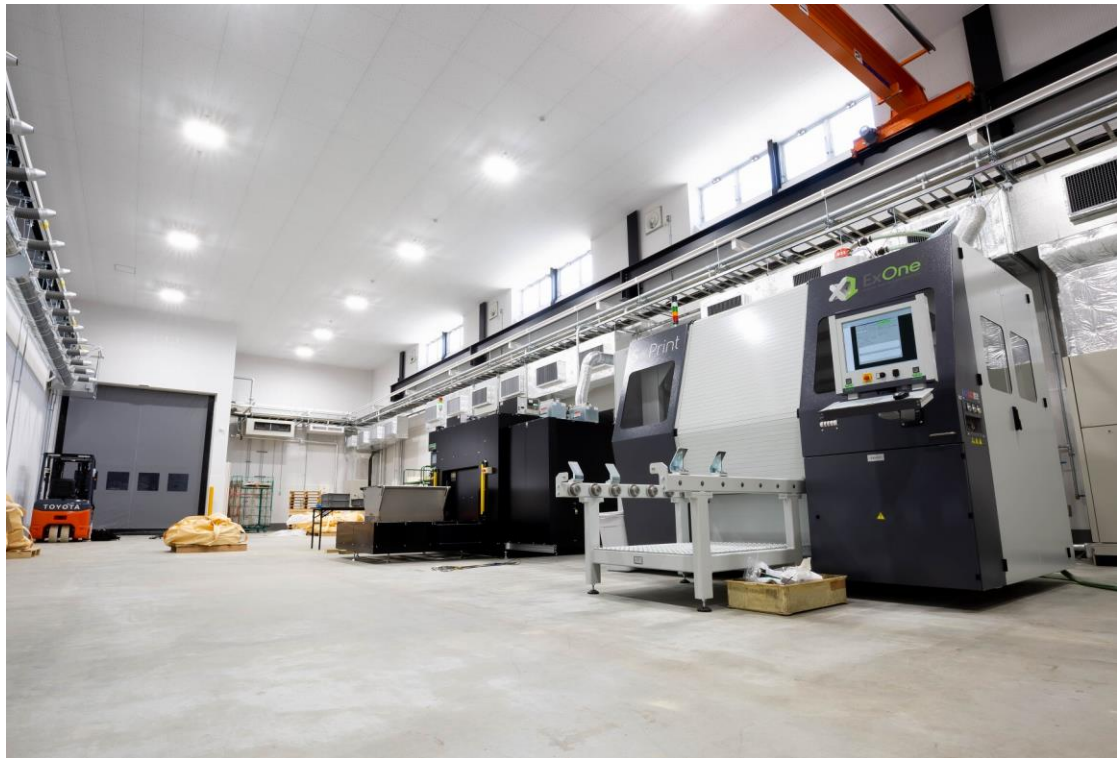
コンセプトセンター第6期棟 砂型造形室
