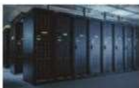
テクノロジー関連REIT データセンター、通信塔など
