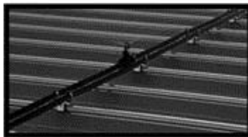
倉庫内温度低減のために 井戸水を利用した屋根散水設備の設置
