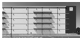
断熱サンドイッチパネルの採用
