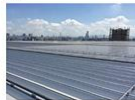
太陽光パネル
