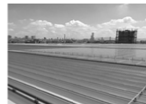
太陽光パネル
