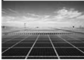
■ 太陽光パネル
