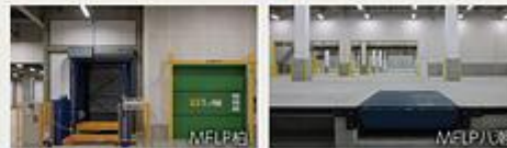
各階を繋ぐ垂直搬送機 作業効率を高めるドックレベラー® ※「ドックレベラー」とは、物流施設のプラットフォームとトラックの荷台の段差を無くし、円滑にトラックの荷台へフォークリフトや台車を誘導するための装置をいいます。
