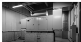
非常用発電機
