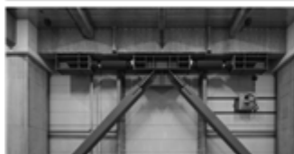
制振ブレース
