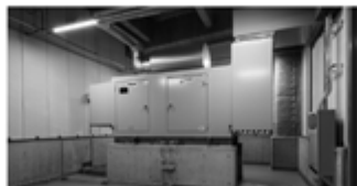
非常用発電機
