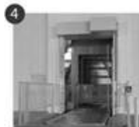
4 垂直搬送機 効率的な荷物搬送を行うための十分な基数
