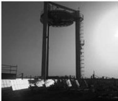
アラブの太陽熱発電の実施設
