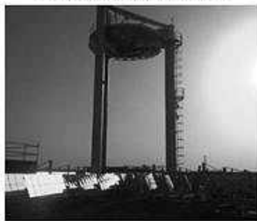
アラブ地域の太陽熱発電の実証施設
