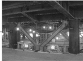
粘性系ダンパー 「セミアクティブオイルダンパー」 (356基設置)
