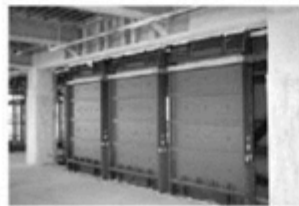
粘性体制振壁
