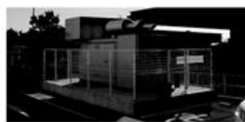
加須物流センター 自家発電機
