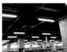
東雲物流センター LED 設備
