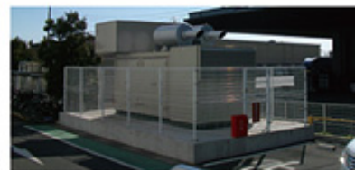
加須物流センター 自家発電機
