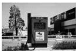
電気自動車用急速充電器の設置 (三井ショッピングパーク ららぽーと磐田)
