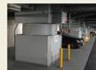
免震装置設置状況(地下1階)
