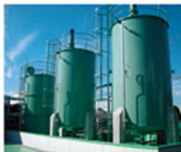
廃油・汚泥処理
