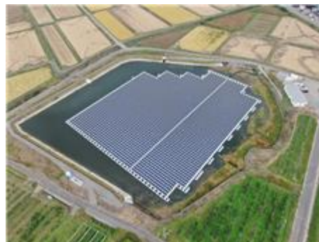
いちご上田吉田池E C O発電所
