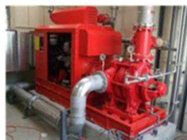
非常用動力装置
