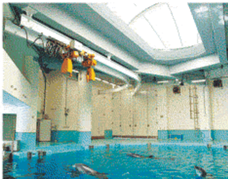
(エンターテインメント) イルカ搬出入用クレーン
