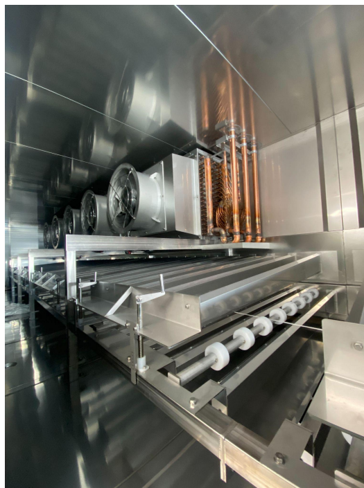
設置中のトンネルフリーザー（2023年12月末）
