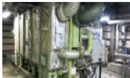
▲受雷型の重油式空調設備
