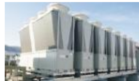
▲導入を進めている電気式空調設備
