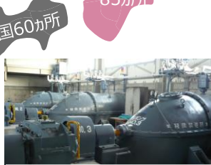
江見下流排水機場 佐賀県神崎市
