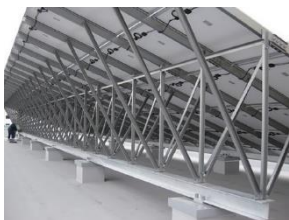
①太陽電池アレイ支持架台
