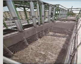
排水処理設備
