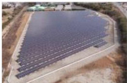
S-03 JEN防府太陽光発電所
