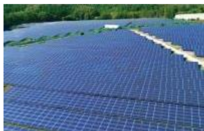
S-05 鉾田太陽光発電所
