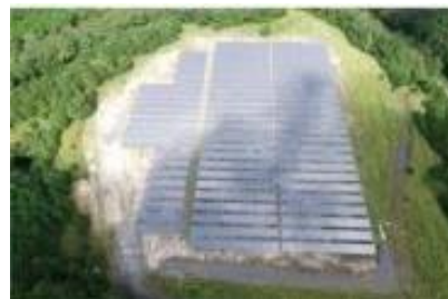
S-02 千代田高原太陽光発電所
