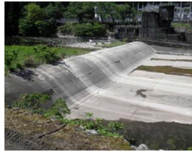
摩耗した固定堰(頭首工)
