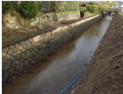
老朽化した石積護岸
