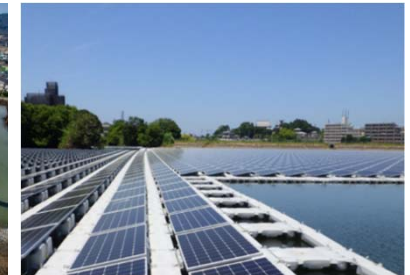
いちご泉南狐池 ECO発電所
