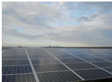
いちご徳島東沖洲 ECO発電所
