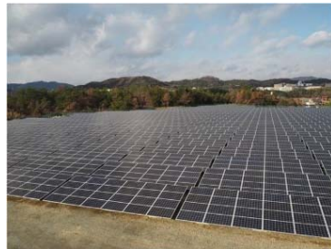
いちご東広島西条町田口 ECO発電所
