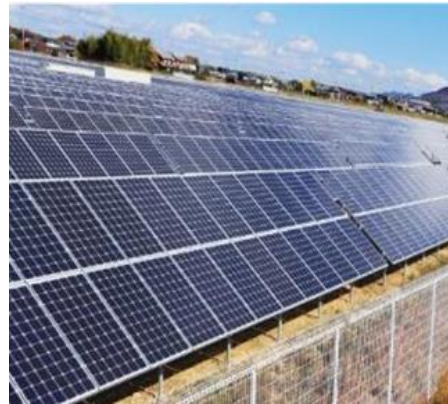
自社太陽光発電所
