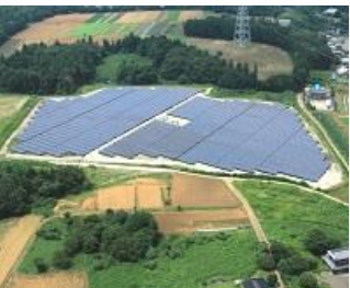
S-12 LSつくば房内発電所
