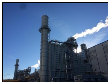
ガスタービン駆動コンプレッサー運転
