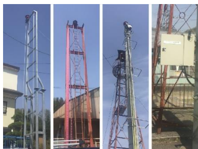
消防・防災設備の遠隔制御
