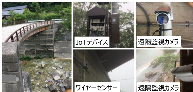
協業による防災IoTソリューション提供（土石流監視・監視）
