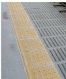
内方線付き点状ブロック
