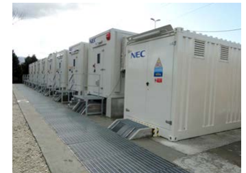
カラブリア州キアラバツレ変電所に設置された蓄電システム
