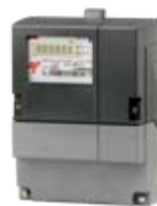
スマートメーター
