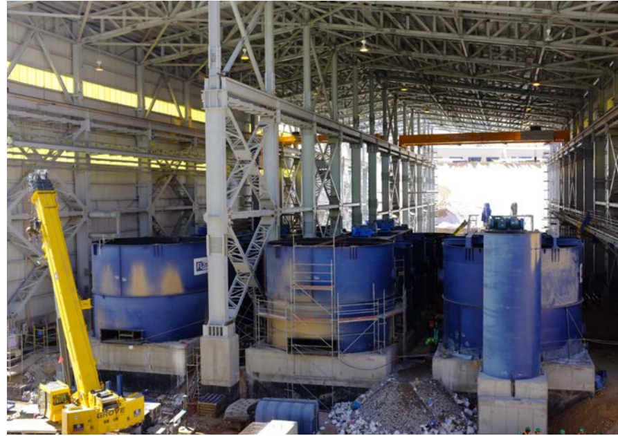
浮選建屋・浮選機
